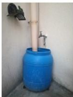
Photo 12 : Robinet, descente d'eau pluviale et bidon d'eau
