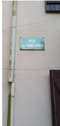
Photo 3 : Descente d'eau pluviale cassée
